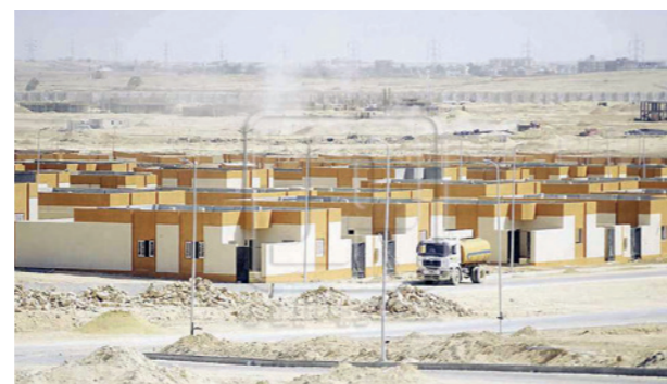
Hilfsgebäude am Standort El Dabaa in Ägypten sind bereits in Bau. (Foto: ENRRA)
